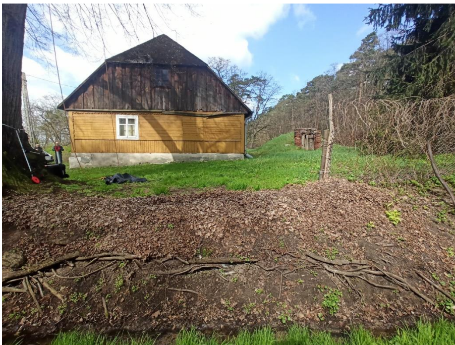
fot. 1.4.2.1 Odslonięte korzenie od strony E
