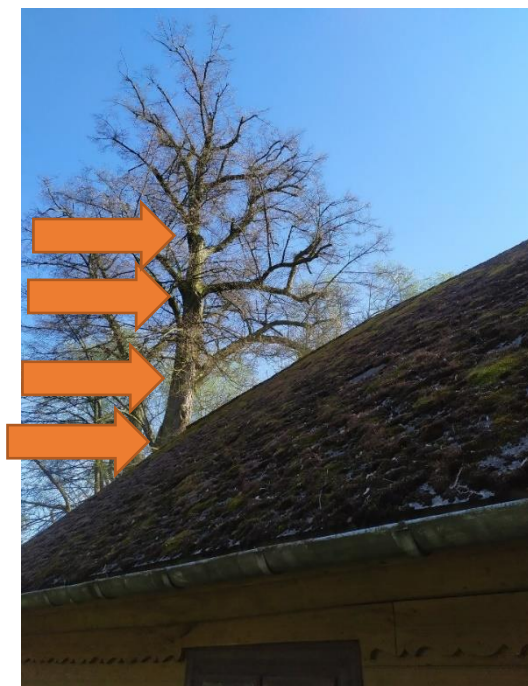
fot. 1.4.4.6 Lokalizacja ubytków otwartych (W)
