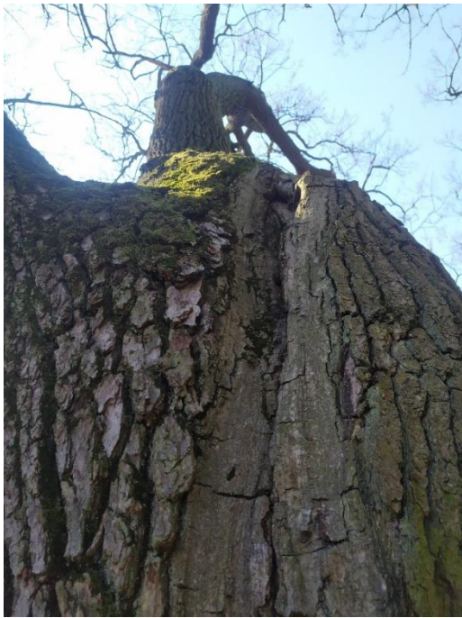
fot. 4.4.5.5 Uszkodzenie przewodnika (W)
