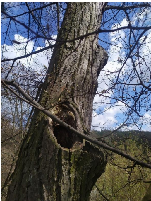
fot. 1.4.4.3 ubytki (E)
