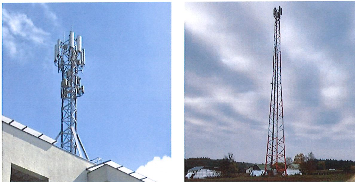
Rysunek 4. Stacje bazowe telefonii komórkowej na dachu budynku oraz wolnostojąca
